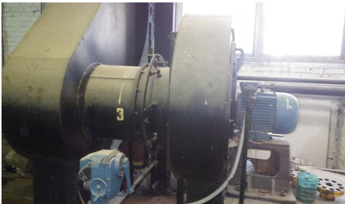
Рисунок 1.2.1.4. Тягодутьевое оборудование котельной.
