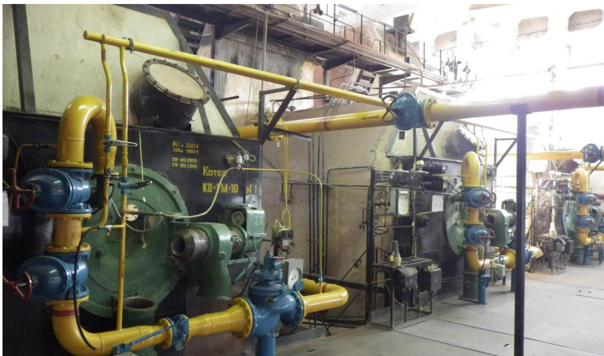
Рисунок 1.2.1.2. Котловое оборудование котельной.
