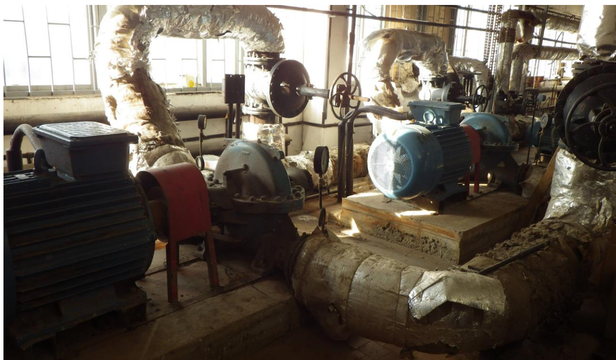
Рисунок 1.2.1.3. Насосное оборудование котельной
