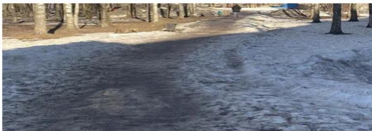
Покрытия в аварийном состоянии деформированные. Необходима замена верхних слоев финишных покрытий, возможно полная замена пирога покрытий
